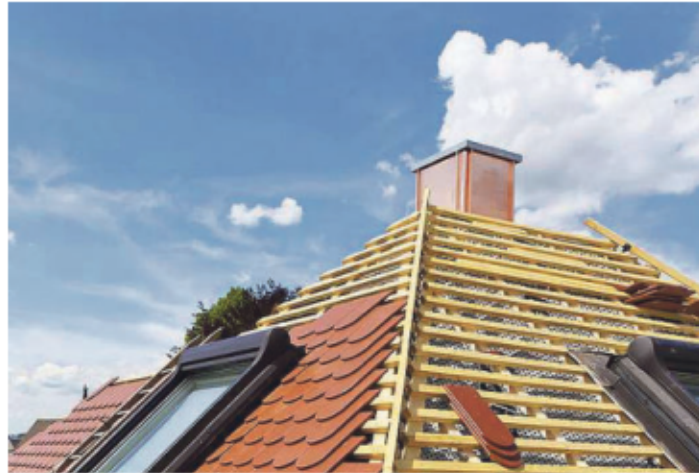
Eine neue Dacheindeckung schmückt nicht nur das Eigenheim, gleichzeitig schützt sie auch die Bausubstanz.
